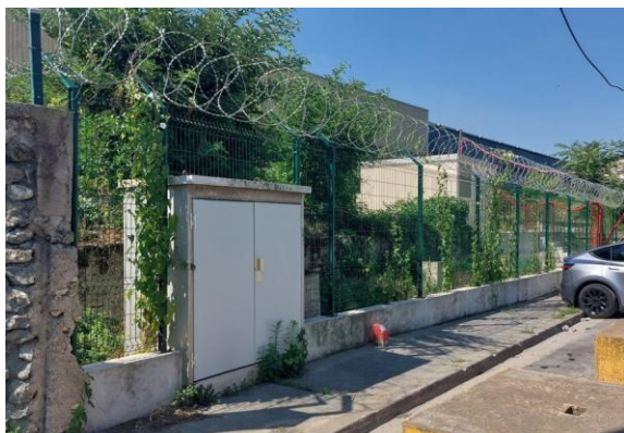
Figure 6 : Poste GRDF à proximité de l'entrée SNCF
