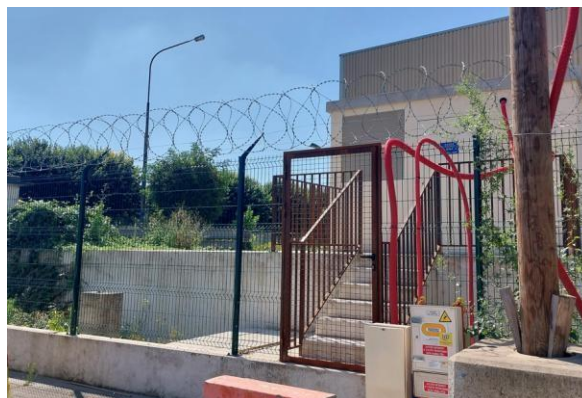
Figure 7 : Poste Enedis à l'angle Mauvais x Tortue
